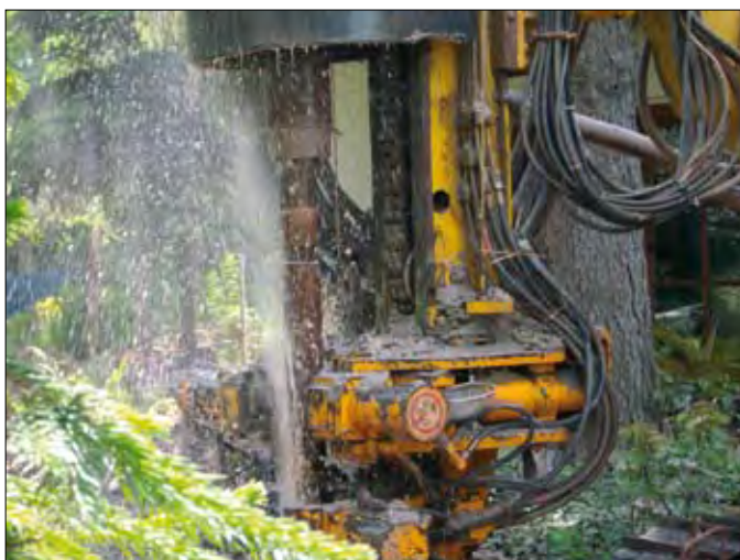
Abb. 7.3-3 Austritt von unter Druck stehendem Grundwasser aus Erdwärmebohrungen (Quelle: Schulz)
