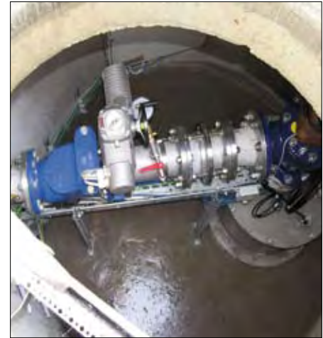
Abb. 7.3-12 Brunnenstube mit wassertechnischer Ausrüstung
