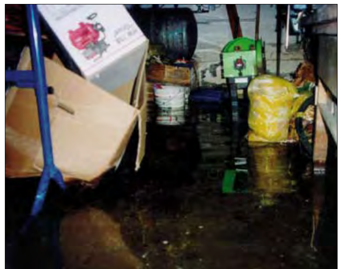
Abb. 7.4-4 Wasser im Keller durch drückendes Grundwasser (Quelle: BWK)
