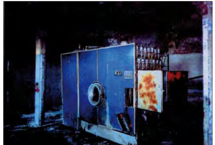
Abb. 8.3-13 Die bei Übernahme des Objektes noch im Gebäude befindliche Waschmaschine für Uniformen etc. mit Lösungsmitteln
